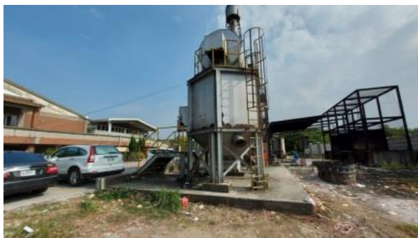
老舊年久失修之金爐
