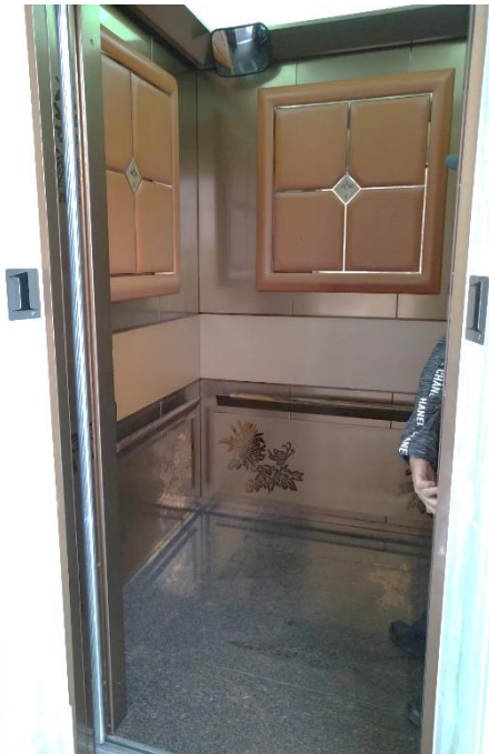
升降機機廂內已設置後視鏡，操作盤前方地面有鋪貼異材質。
