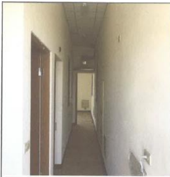
無障礙引導標示牌改善前
