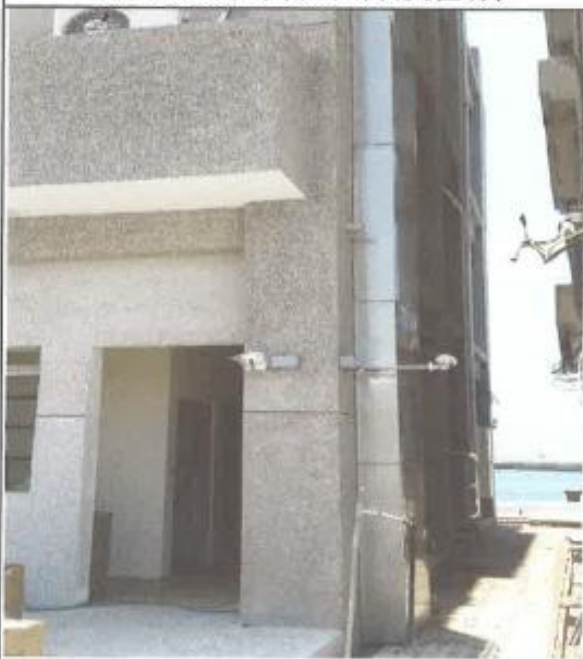
無障礙引導標示牌改善前
