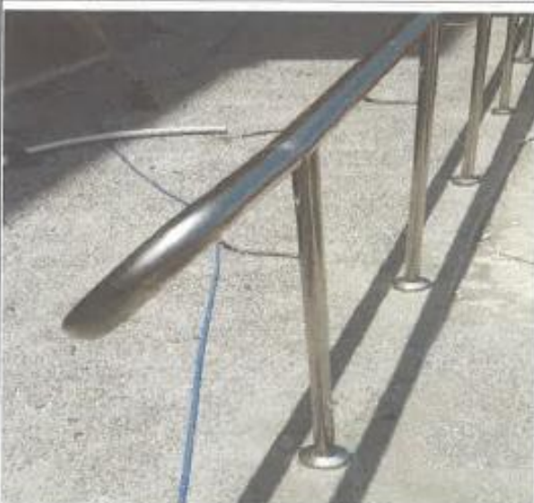
無障礙坡道改善前
