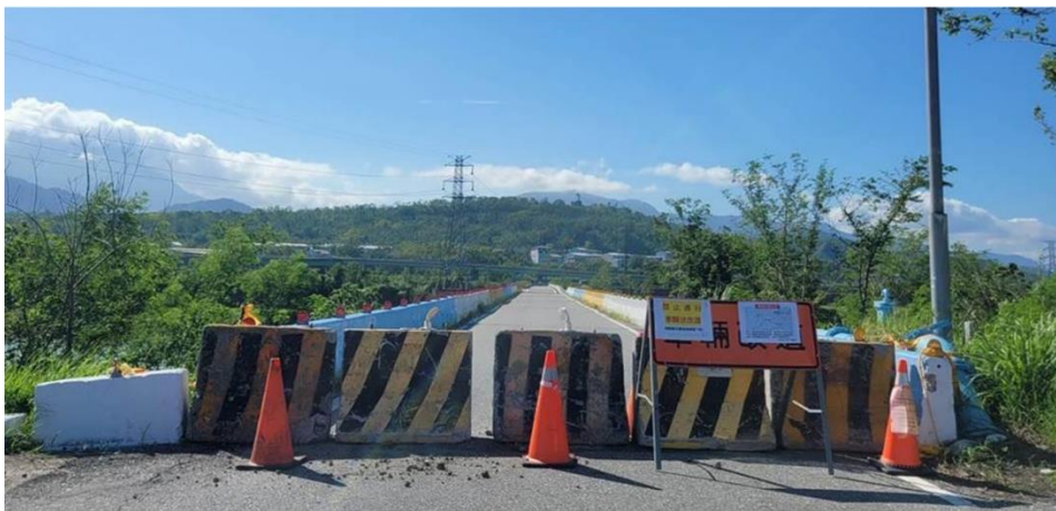
花蓮富里崙天大橋去年9月18日遭強震震毀，正進行重建作業流程，縣府雖闢建便道供民眾出入，今年卻相繼受颱風影響損毀，預計10月底或11月初才能完成修復作業。（富里鄉公所提供 / 羅亦琳花蓮傳真）
