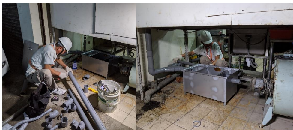
圖 24 油脂截留器裝設實況
