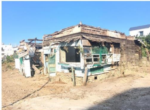
修復前，屋頂、門窗已嚴重破損
