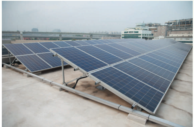
頂樓設置太陽能設備 貫徹再生潔淨能源理念
