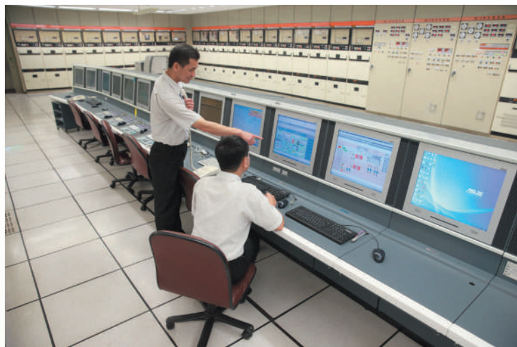
院內機組員 24 小時輪班，控管水、電、蒸汽系統，掌握能源的使用情形
