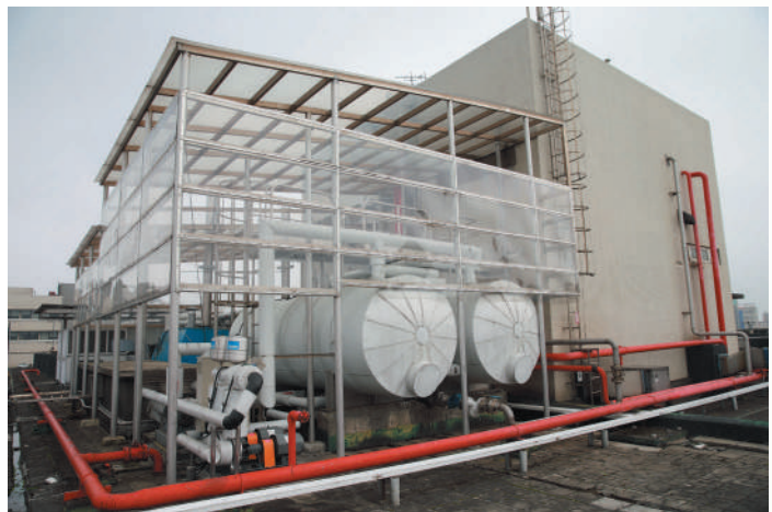
2012 年建置熱泵系統，達到節油功效
